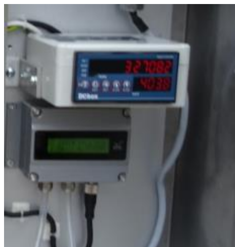
Rys. 2. Panel pomiarowy (rejestrator i sumator) przepływomierza stosowanego w nowych stacjach ASS-500
