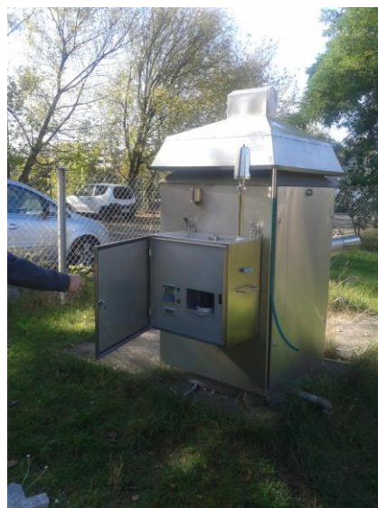
Rysunek 3. Stacja będąca częścią składową stacji ASS-500.
